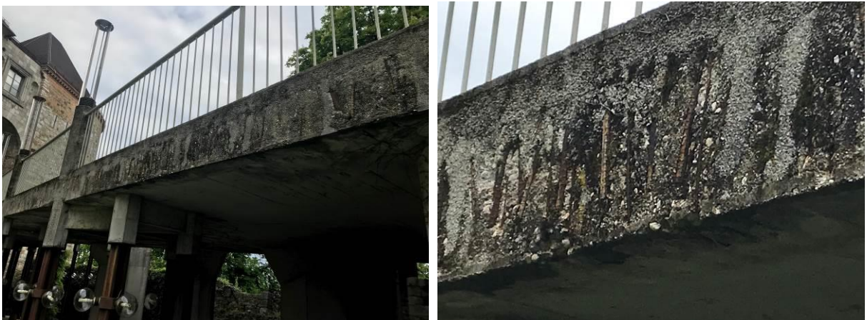
Slike 11 in 12: Korozija armaturnih palic na čelni površini robnega venca
