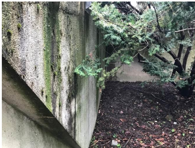
Slike 13, 14 in 15: Razpoke in odprti delovni stiki ter razraščanje alg in mahov na betonskih površinah krajnega opornika
