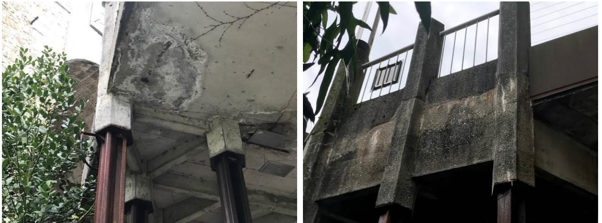
Slike 7, 8, 9 in 10: Zamakanje na spodnji strani prekladne konstrukcije preko čelne strani robnega venca in razpoke na podaljšanih delih robnega venca
