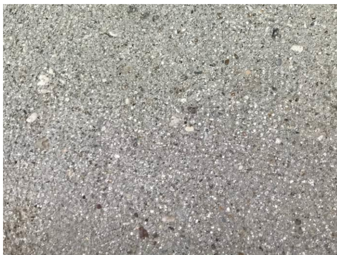
Slika 18: Nespravna površina betona na stebri. Betoni so bili na čelu robnega venca, stebrih in oporniku štokani
