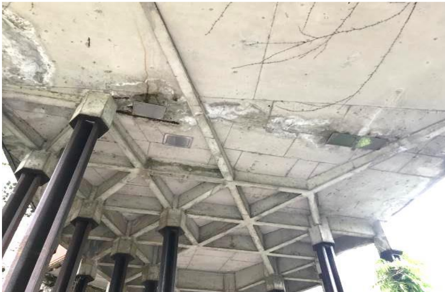
Obstoječe stanje – pogled na vstopni most in stanje zamakanja betonske konstrukcije
